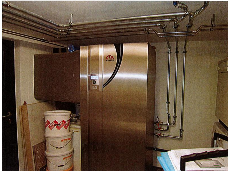
Heizleitungen im Heizraum
