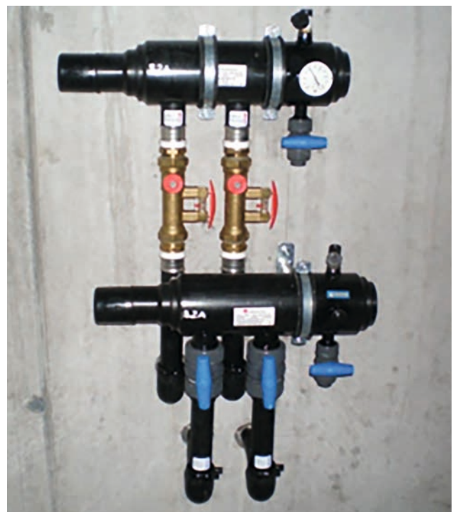
Distributeur/collecteur avec deux sondes géothermiques
